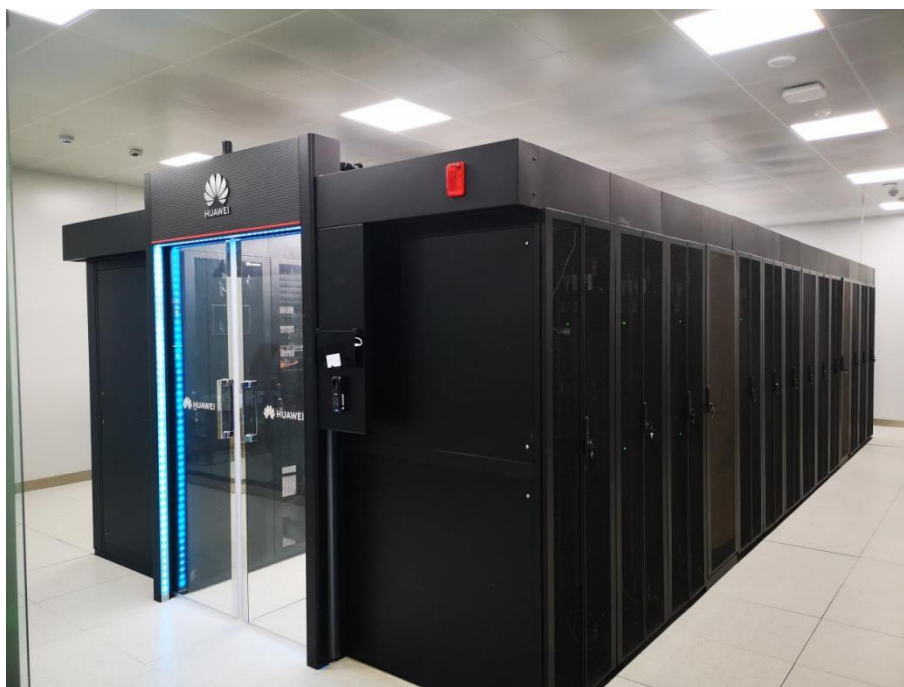
图 13：学校数据中心机房
